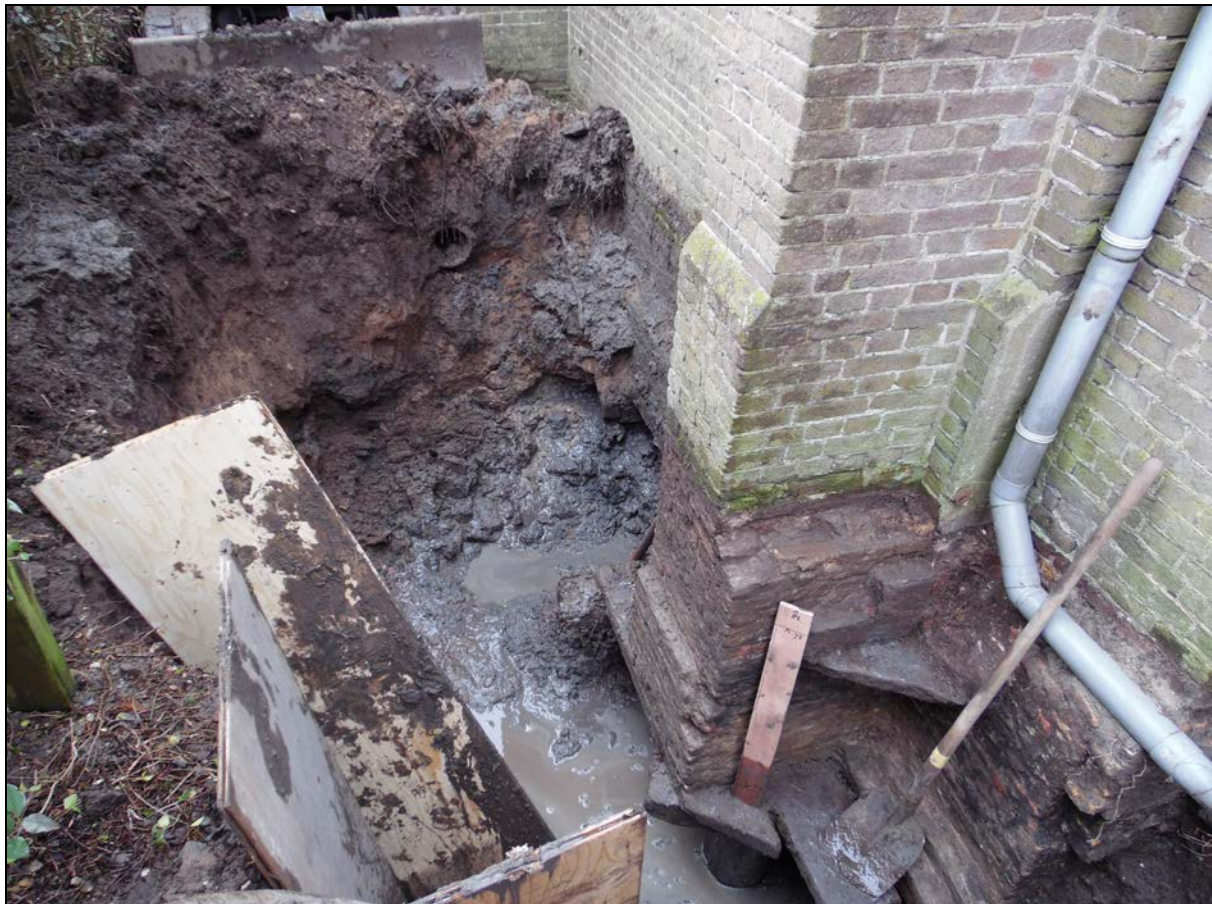
Afbeelding 6. De noordwestelijke hoek van het kerkgebouw. Op de foto zijn de wateroverlast en modder duidelijk zichtbaar.
