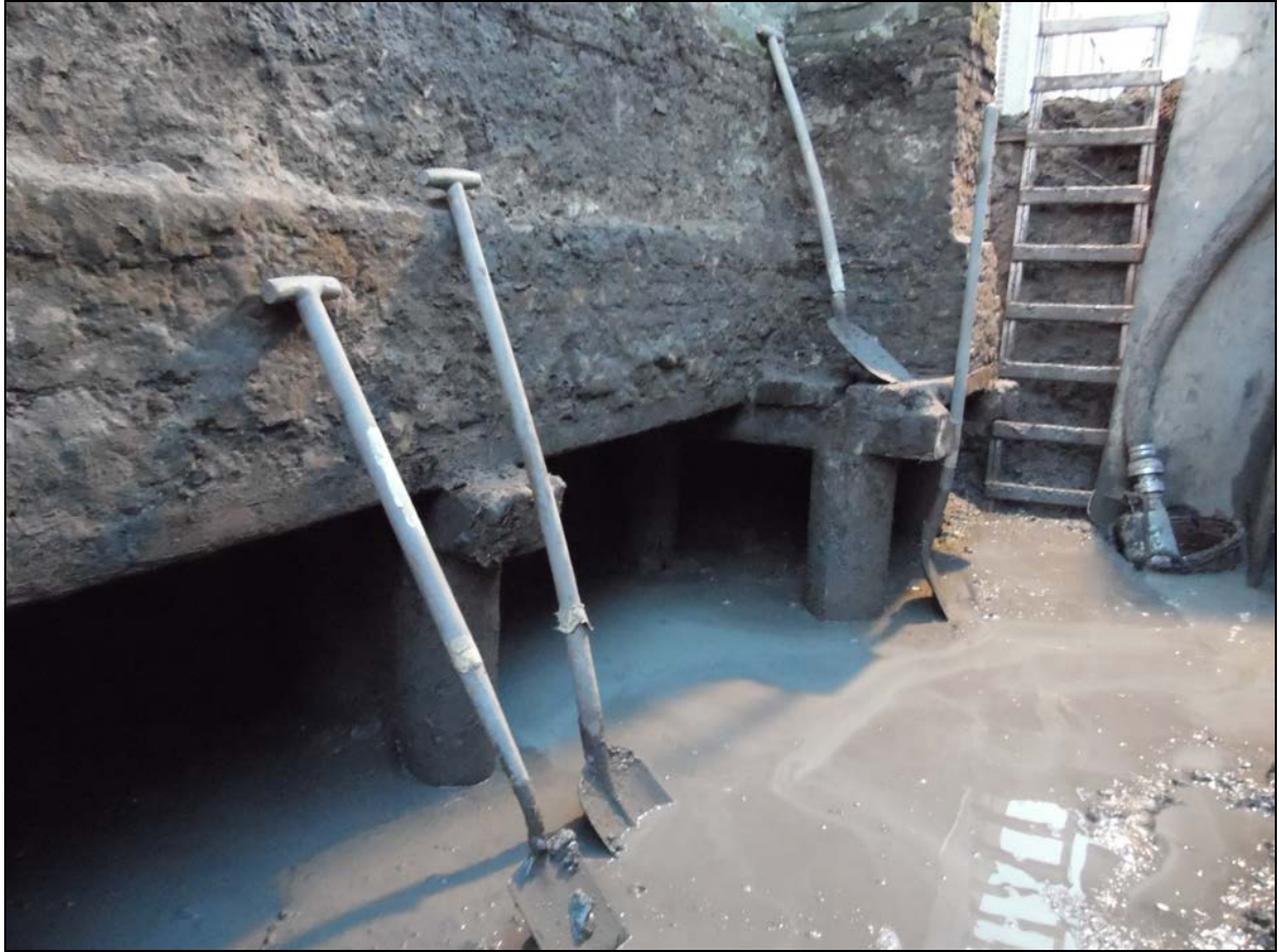
Afbeelding 7. De noordwestelijke hoek van het kerkgebouw. Op de foto zijn de wateroverlast en modder duidelijk zichtbaar.
